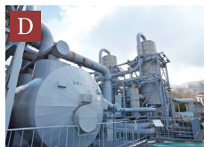
八丁原地熱発電所
